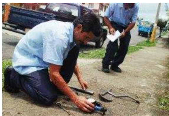
Figura 2. Detalle de instalación y lectura de un micromedidor.
